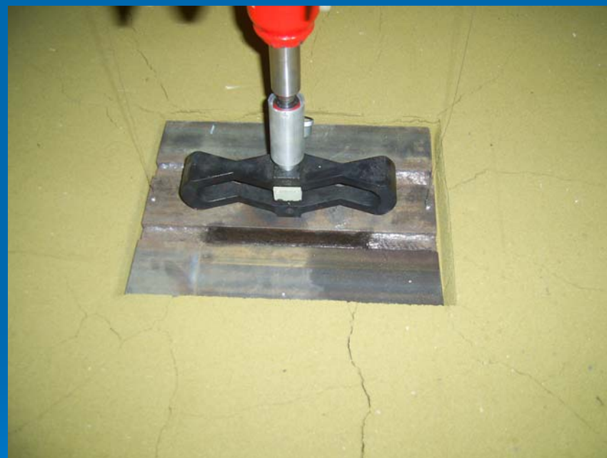
Трещины на поверхности песка
